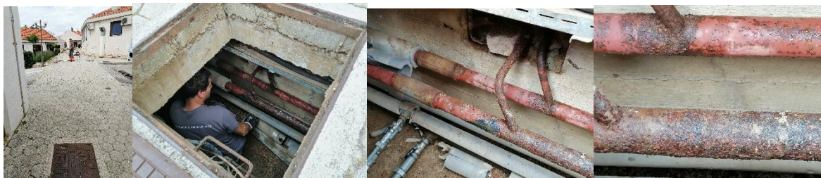
Slike 2-5 Revizijski poklopac i snimke cjevovoda ogrjevne vode
